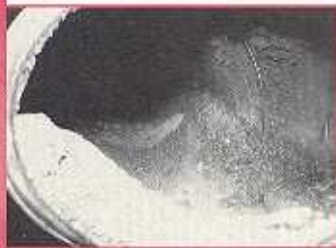
Rußablagerungen im Rauchrohr
